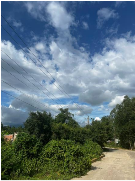
Hình ảnh điện 22KV hiện trạng
